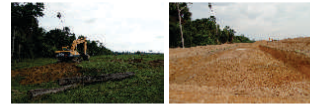
Figuras 7.03 e 7.04 - Processo de escavação de viveiros na Piscicultura Nunes, Comunidade Céu Azul - 17 de novembro de 2014 - Alta Floresta-MT
